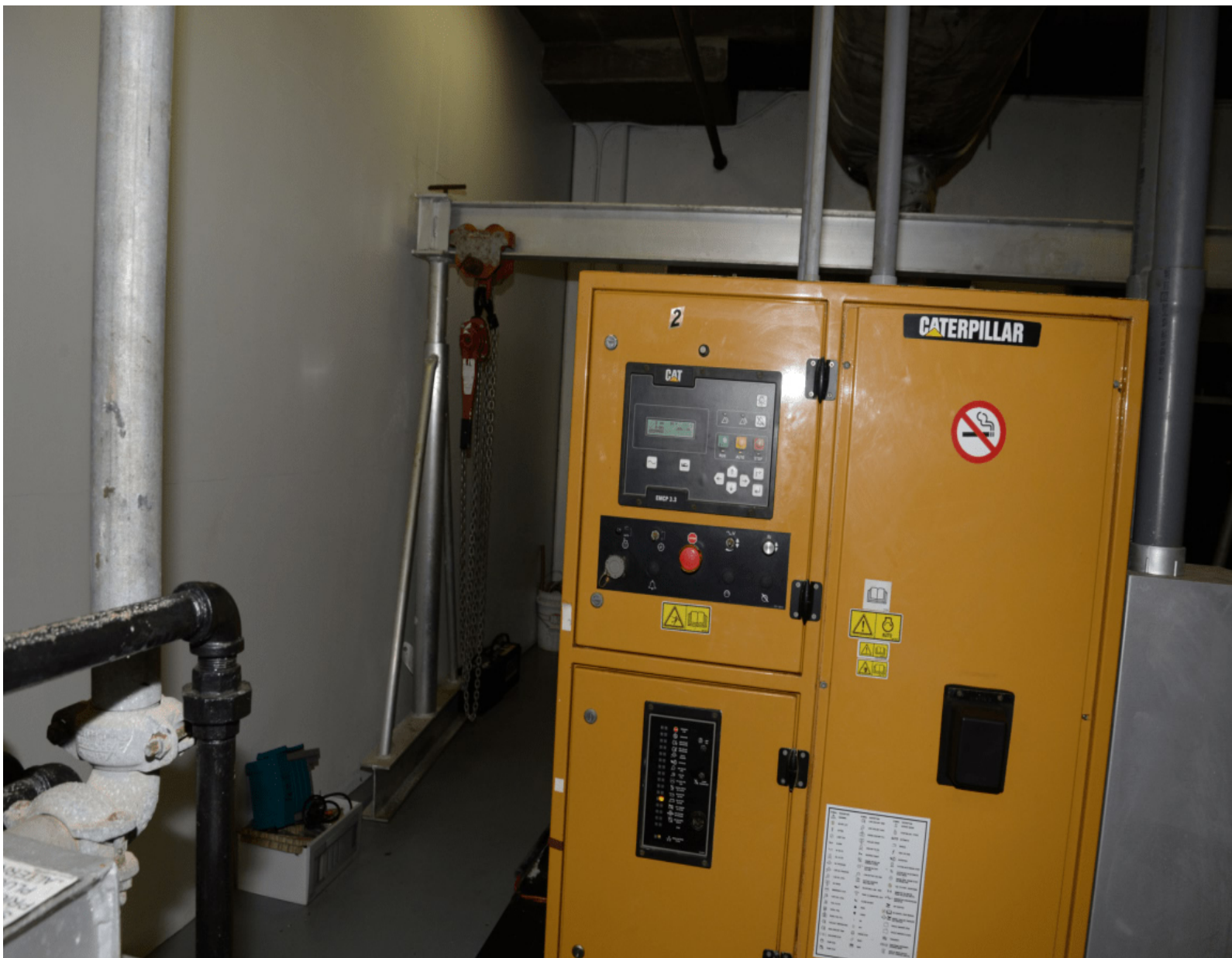
Gerador Amarelo Caterpillar em Sala Industrial com Tubulações e Painéis de Controle (Código: EFTA00002728)
